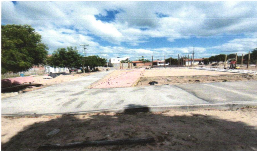
FOTO 03 : ASSENTAMENTO DE GUIA (MEIO-FIO) EM TRECHO RETO, CONFECCIONADA EM CONCRETO PRÉ-FABRICADO, DIMENSÕES 100X15X13X20 CM (COMPRIMENTO X BASE INFERIOR X BASE SUPERIOR X ALTURA), PARA URBANIZAÇÃO INTERNA DE EMPREENDIMENTOS. AF
